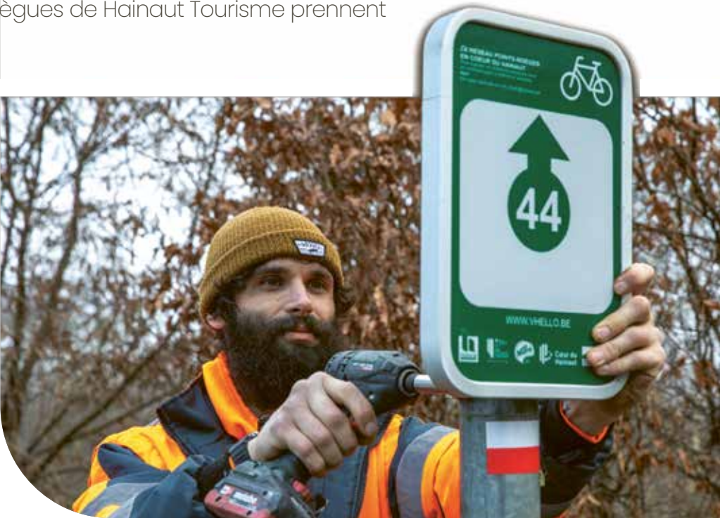
Deux agents de l'équipe technique assurent la maintenance des points-nœuds, ils interviennent sur les poteaux ou panneaux endommagés ou les modifient suite aux adaptations des tracés.
